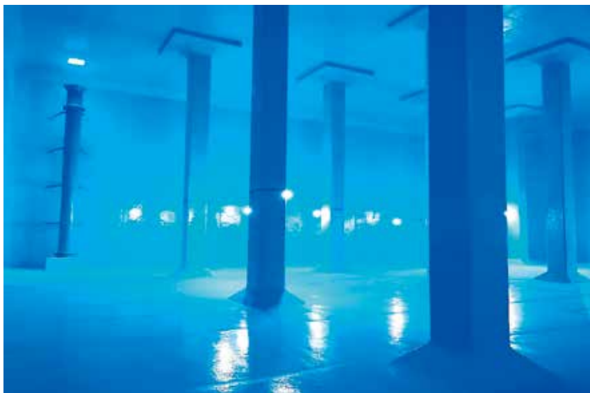
二村山配水場の内部(リフレッシュ工事後)
