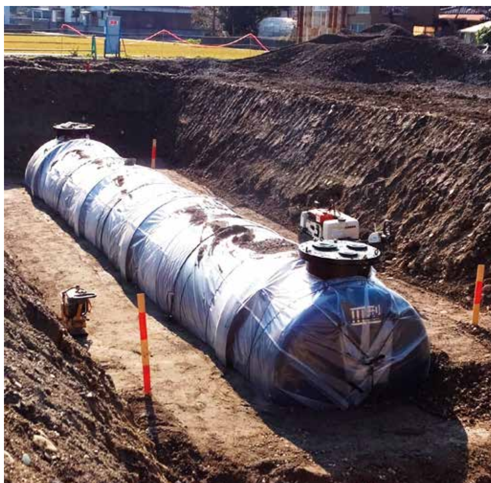
耐震性貯水槽(写真提供：(一社)日本ダクタイル鉄管協会)
