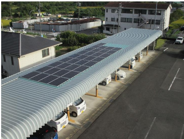
愛知中部水道企業団庁舎 太陽光発電設備
