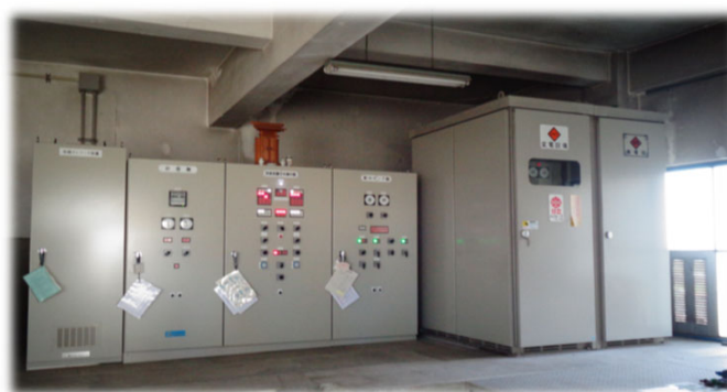
受電設備、計装盤、ポンプ盤
